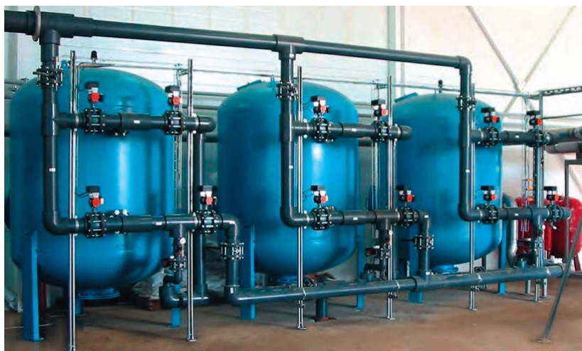
ООО «Данон Индустрия» Станция обезжелезивания 20 м 3 /час
