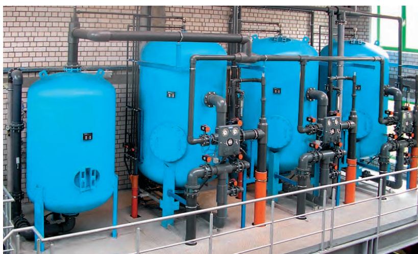
Завод «КРОНОШПАН» Станция обезжелезивания 90 м 3 /час
