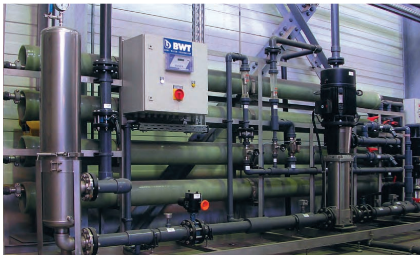
Завод «КРОНОШПАН» Водоподготовка для котельной Установка обратного осмоса 20 м 3 /час
